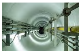
canalisations basse pression
